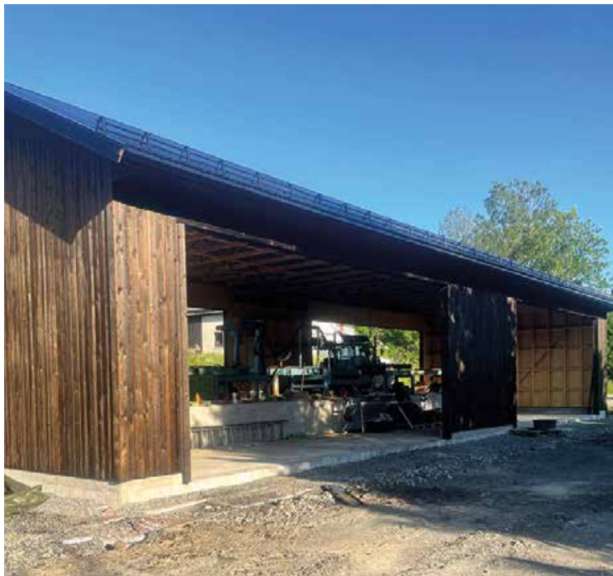
Kun montering av portane gjenstår på det nesten 200m2 store saghuset. Måla er 7,5m x 25,5m.
